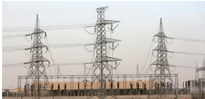
محطة سدبر لتحويل الكهرباء
